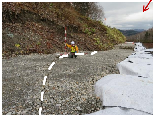
下流面の路面亀裂（高低差約0.25m）
