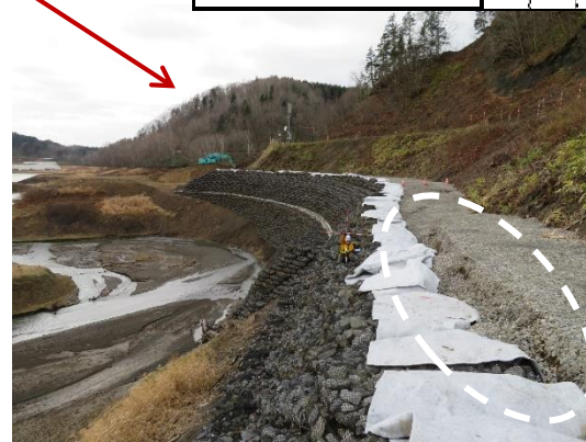
上流面における路肩の沈下
