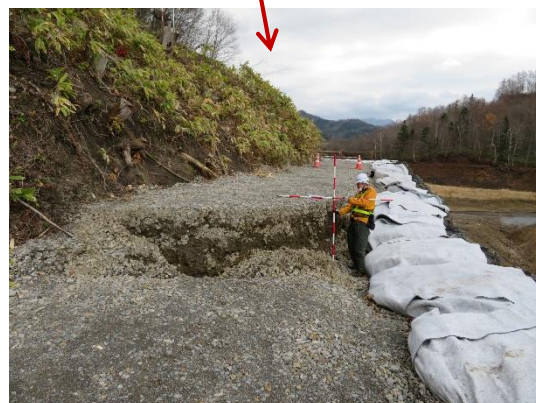
上流面の路面亀裂（高低差約1.2m）
