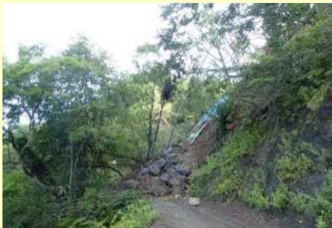
大雨による道路法面の小規模崩壊 等
