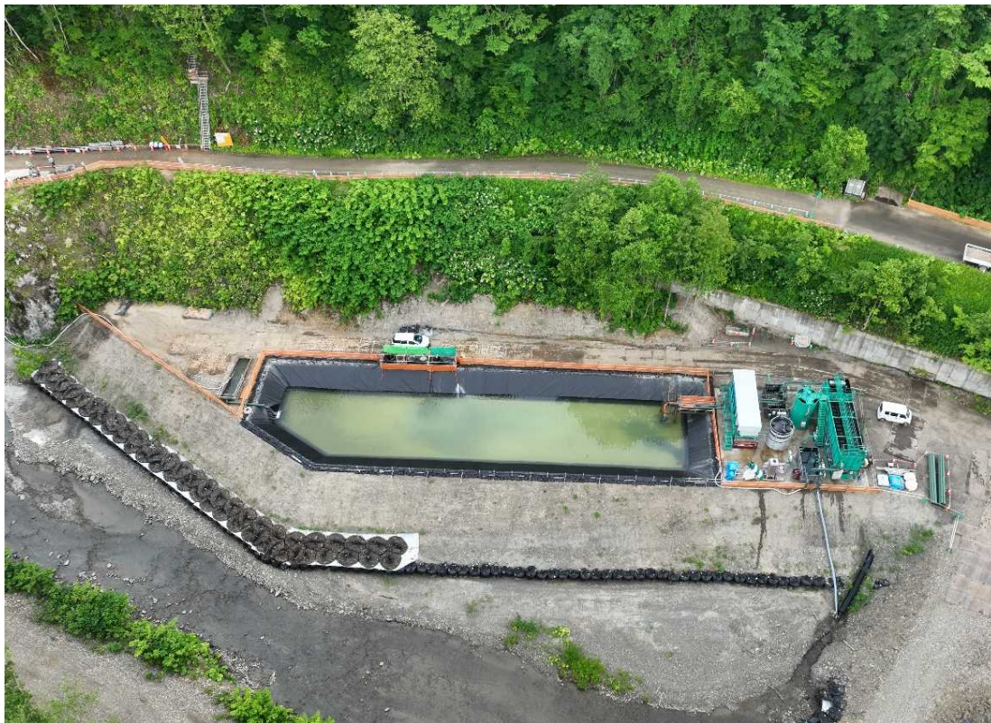
濁水処理設備工 (R5.7撮影)
