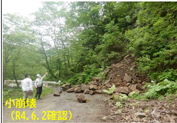
令和4年6月2日 岩盤小崩壊確認
