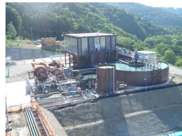
【濁水処理設備(骨材プラント)】
