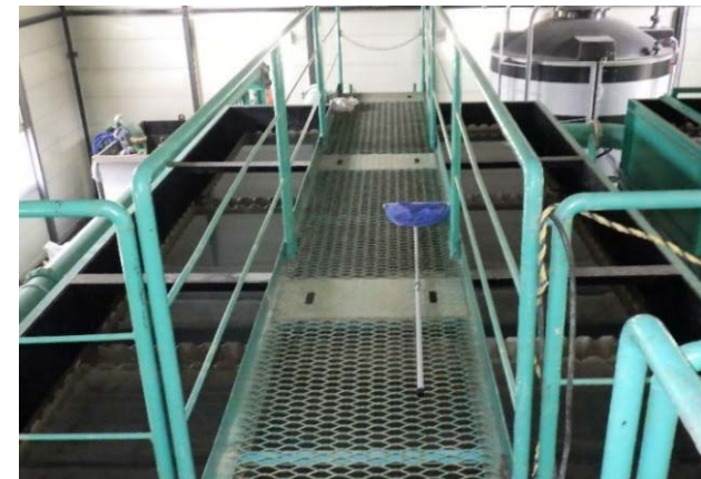
【濁水処理設備(ダムサイト)】
