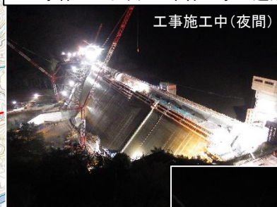
工事休止によりダム本体工事が遅延
