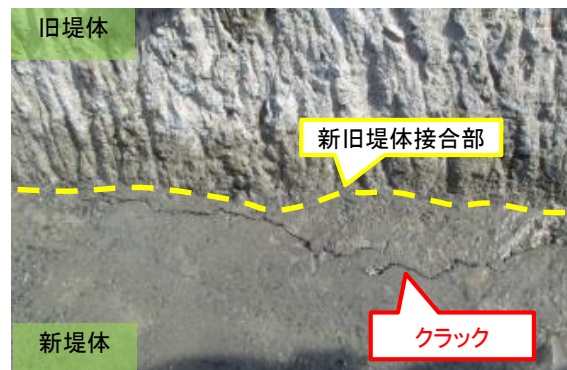
クラック発生箇所
