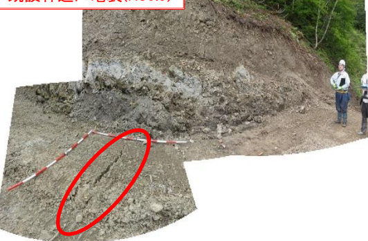
既設林道に亀裂(H30.9)
