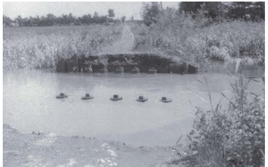
北村6号橋流出跡 ②
