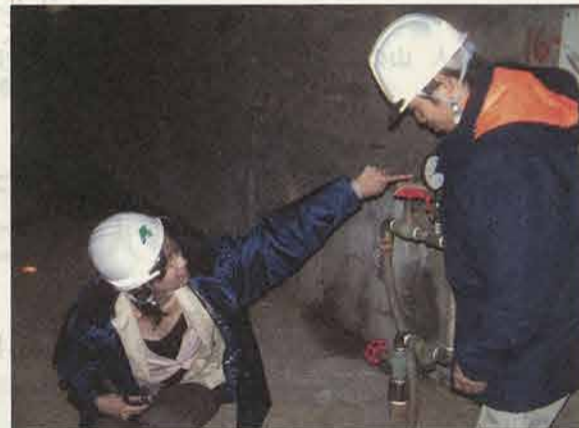
⑤監査廊に戻ると、パイプから水が出ていました。ダムを下から持ち上げようとする力があるからなんですって
