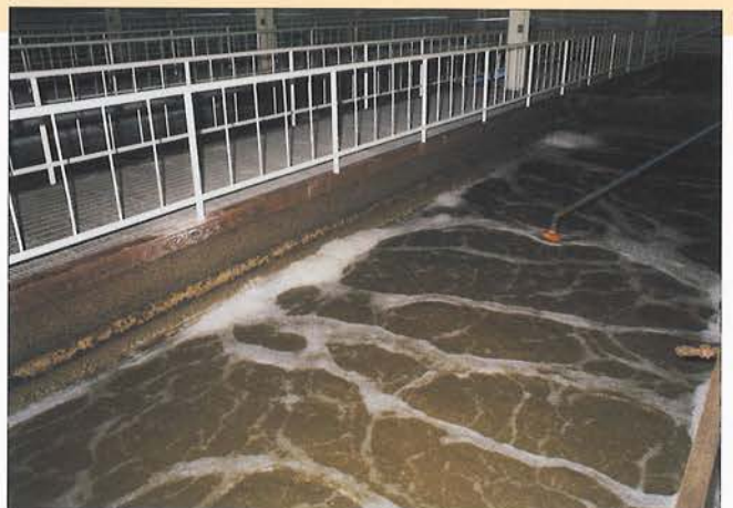
下水処理（エアレーションタンク）のようす
