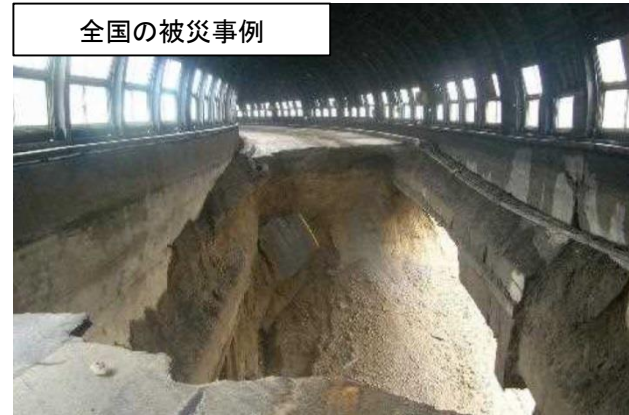
国道274号日勝峠の被災状況 (平成28年8月北海道大雨災害)
