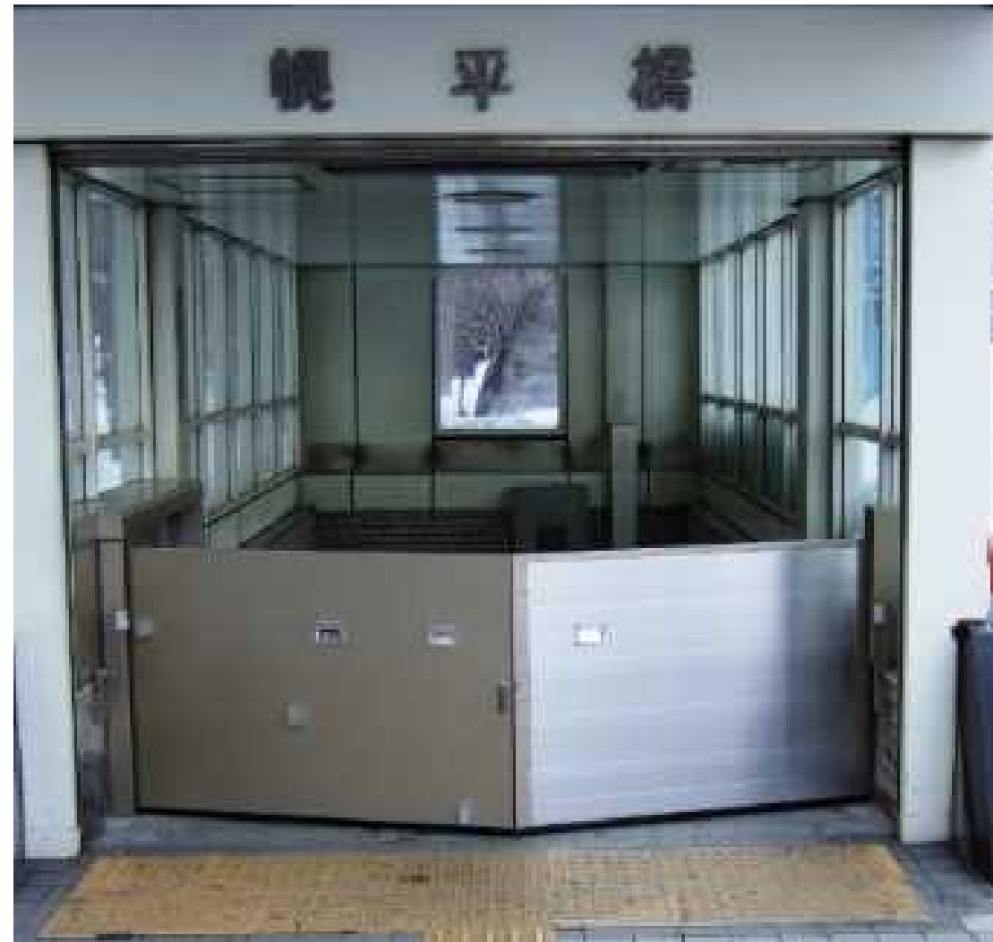
札幌市営地下鉄 札幌平橋駅入り口における設置事例
