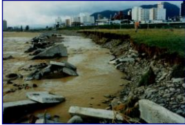
河岸の洗掘状況（南大橋上流左岸）
