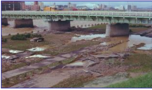
高水敷の洗掘状況（幌平橋直下流左岸）
