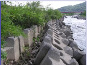
河床洗掘により低下した既設護岸
