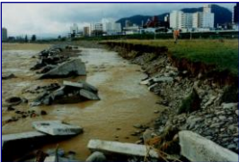
河岸の洗掘状況（南大橋上流左岸）
