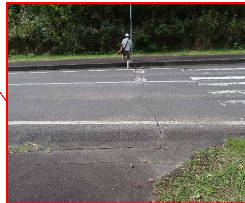
道路横断クラックが確認された。
