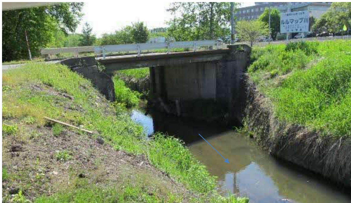
南18号橋【着手前】
