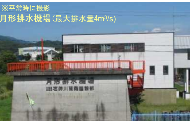
※平常時に撮影 南6号排水機場(最大排水量26m 3 /s)
