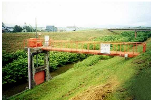
※門柱部の劣化
