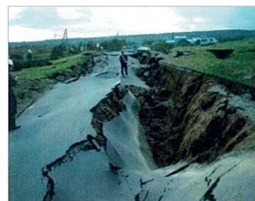
平成15年9月 十勝沖地震 豊頃町大津で の堤防被災状況
