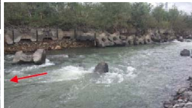
【根固工の沈下状況(出水後に撮影)】
