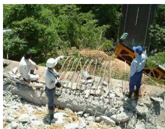
被災状況調査班 (現地調査)
