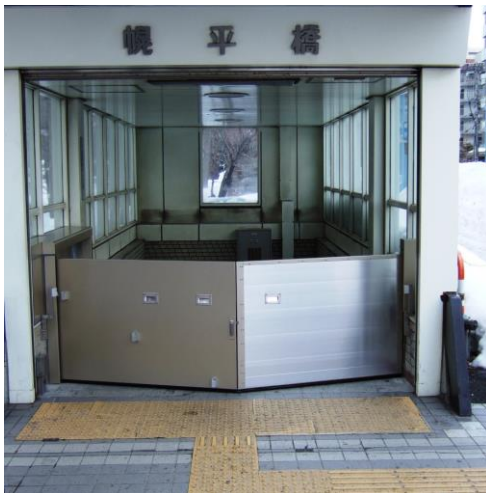
地下空間への流入防止の対策
