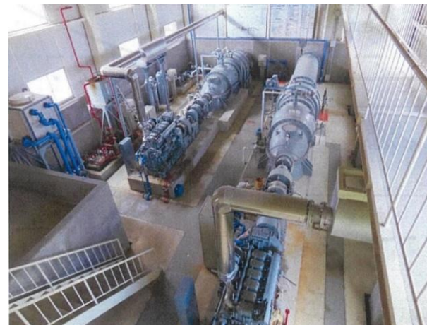
・碧水排水機場
