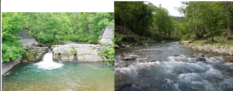
上流既設堤体の損傷・洗堀が進行している状況
