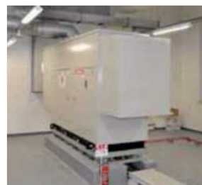
非常用発電設備のイメージ
