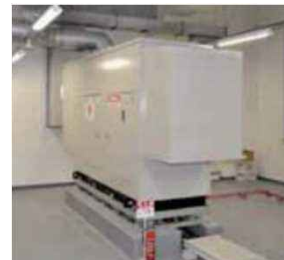
非常用発電設備のイメージ
