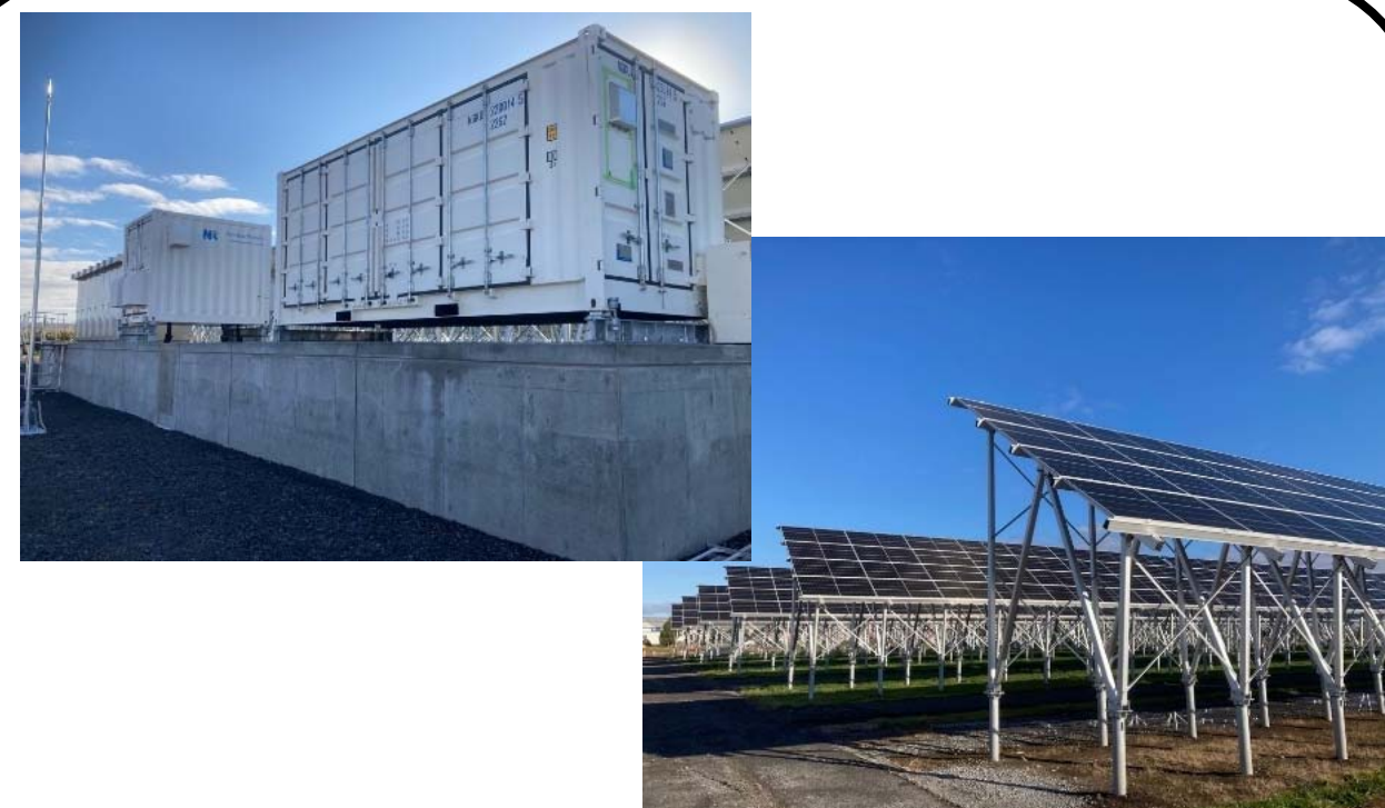
地域マイクログリッド設備(NAS®電池、太陽光パネル)
