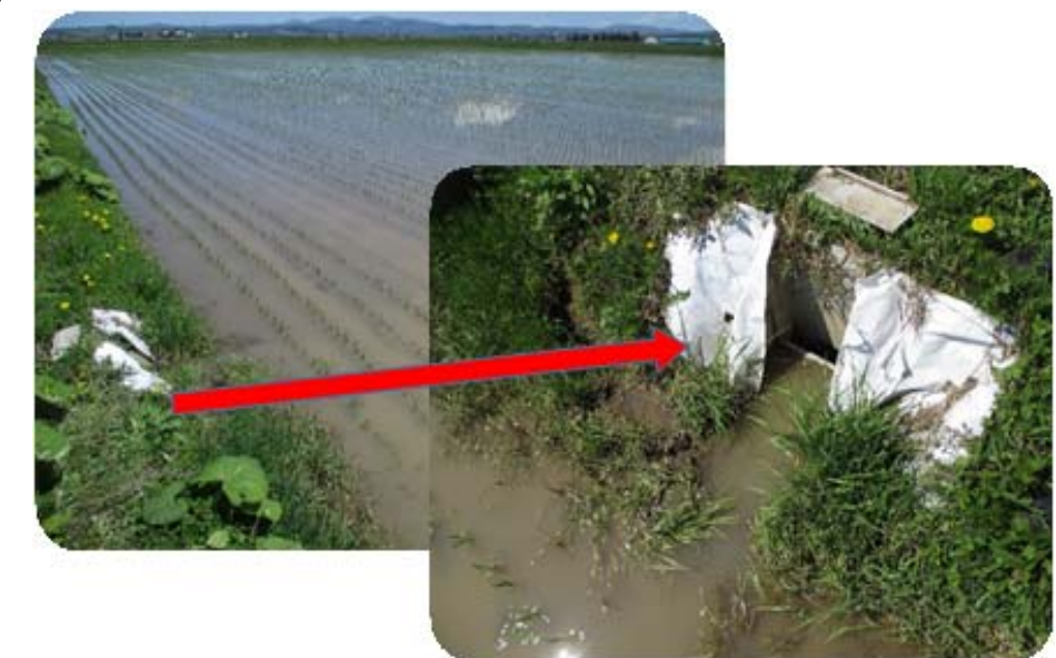
農業用施設による流出抑制対策(田んぼダム)
