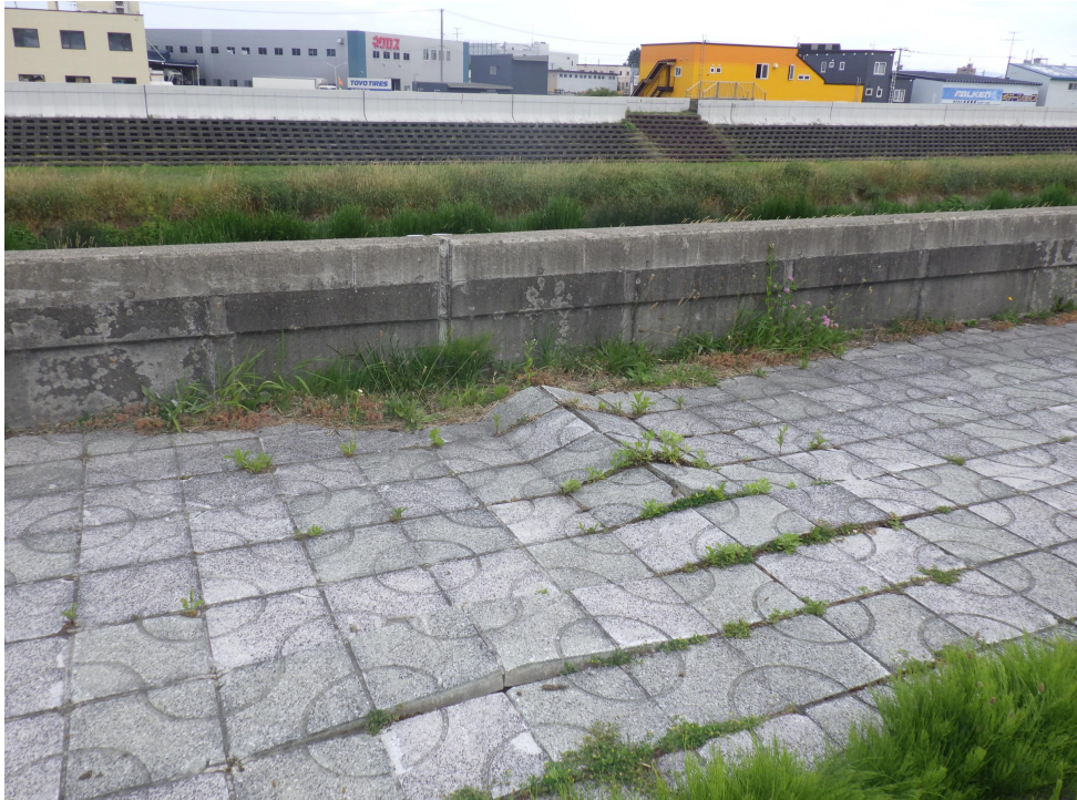
○撮影場所 : 望月寒川左岸KP1.2 ○写真説明 : 平板ブロック浮き上がり
