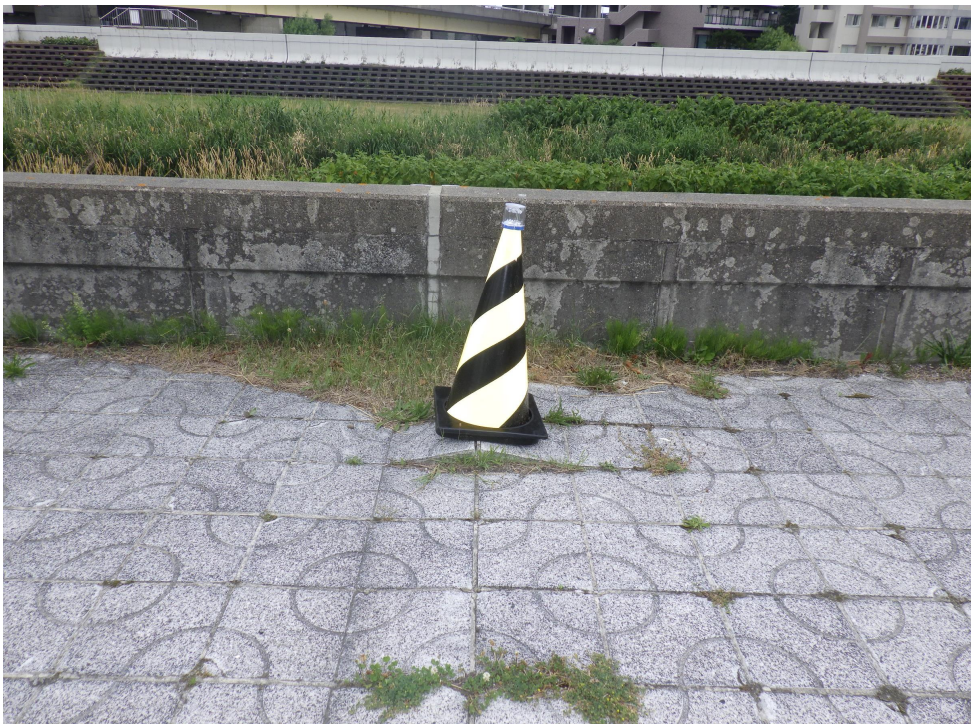
○撮影場所 : 望月寒川左岸KP1.4 ○写真説明 : 平板ブロック浮き上がり
