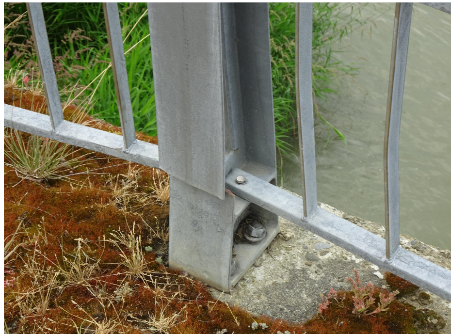
○撮影場所：清幌床止(夕張川KP=9.0) ○写真説明：支柱の破断箇所
