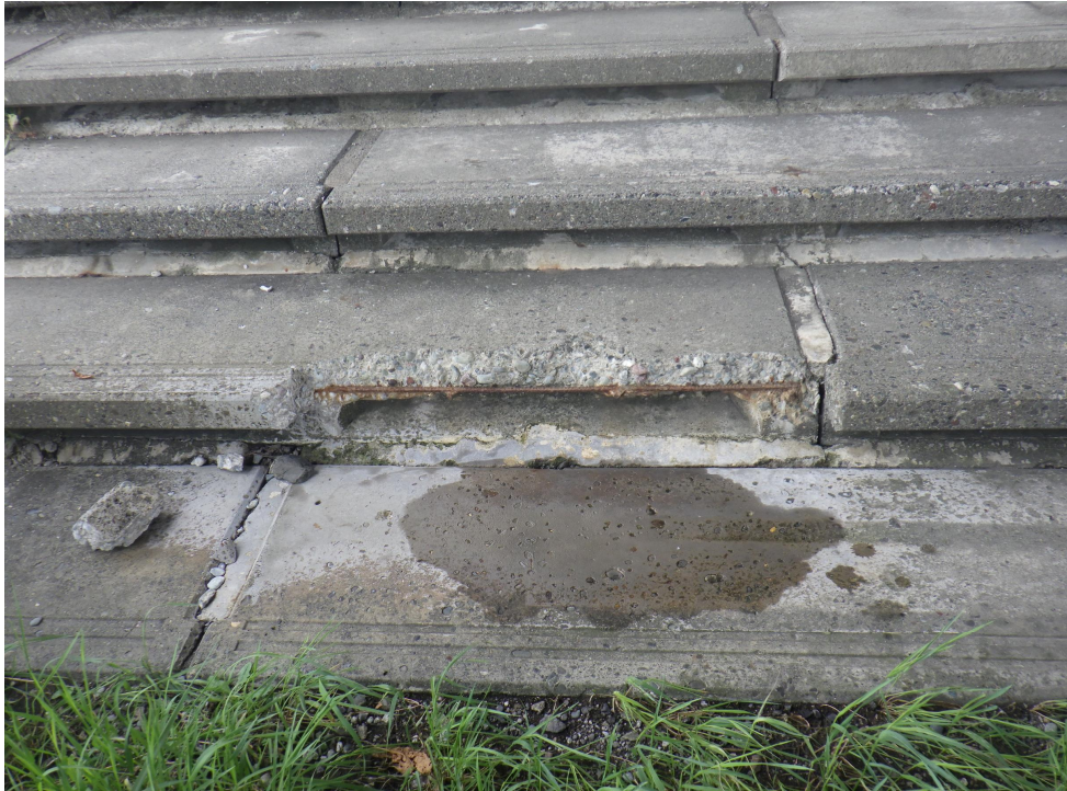
○撮影場所 : 豊平川左岸KP16.1 ○写真説明 : 階段護岸の損傷
