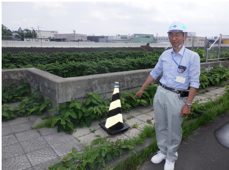
○撮影場所：望月寒川左岸KP1.00 ○写真説明：平板ブロック浮き上がり
