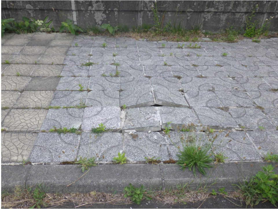
○撮影場所 : 望月寒川左岸KP1.5 ○写真説明 : 平板ブロック浮き上がり
