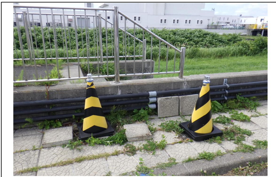
○撮影場所：望月寒川右岸KP2.1 ○写真説明：平板ブロック浮き上がり
