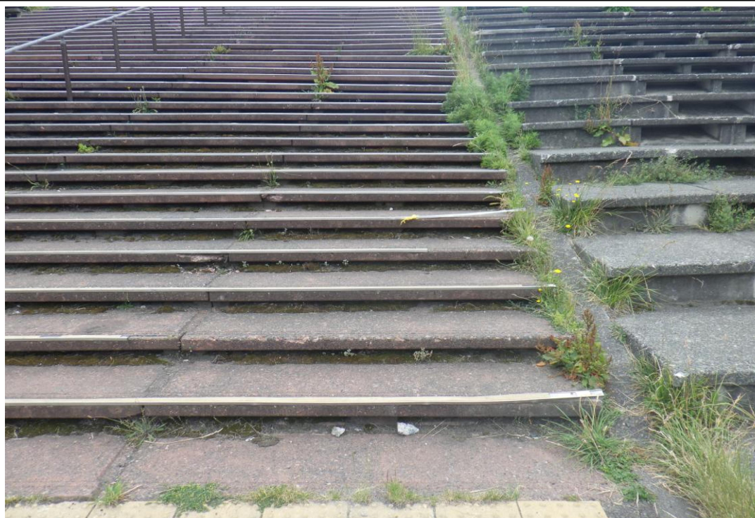
○撮影場所 : 豊平川左岸KP15.5 ○写真説明 : 階段ステップ部損傷
