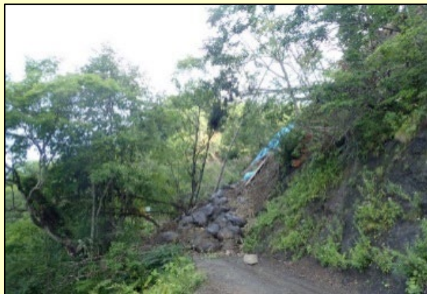
大雨による道路法面の小規模崩壊 等
