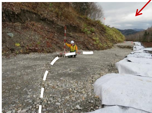
下流面の路面亀裂(高低差約0.25m)
