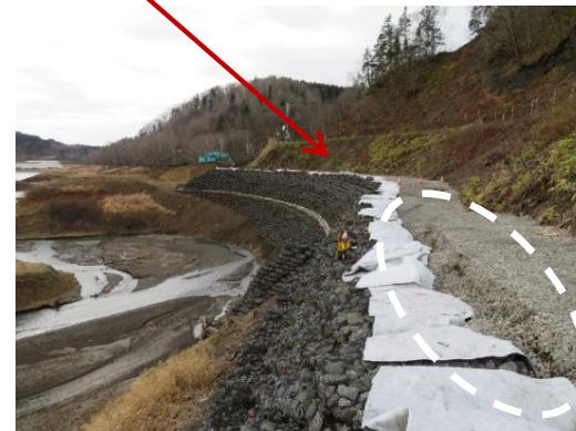
上流面における路肩の沈下
