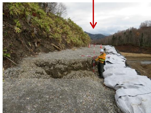
上流面の路面亀裂(高低差約1.2m)
