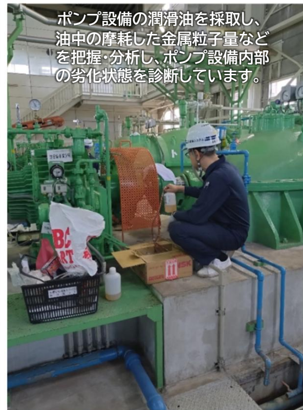
金子排水機場（岩見沢市）の ポンプ設備内の潤滑診断調査
