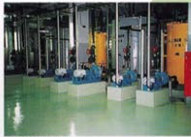
▲薬品注入設備
