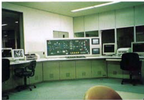
▲浄水施設 中央管理室
