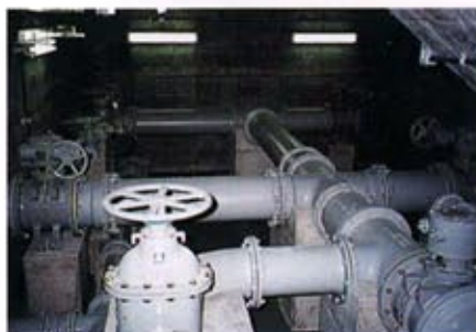
▲里見配水池配管
