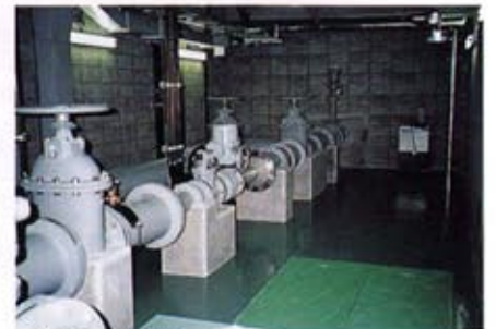
▲浦臼配水池配管
