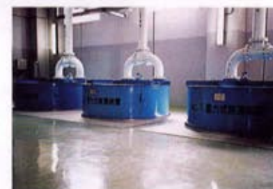
▲浄水施設 重力式除濁装置
