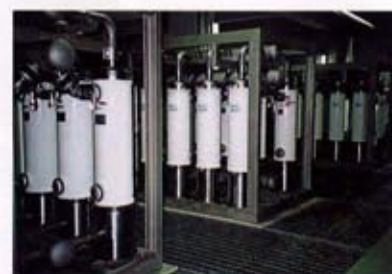
▲浄水施設 膜ろ過ユニット
