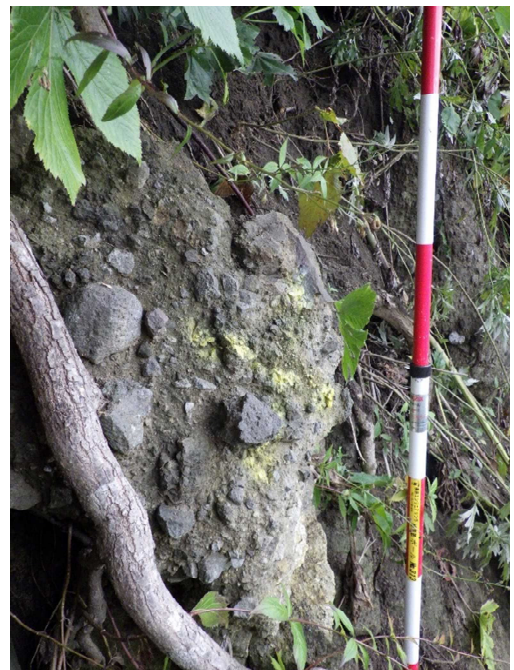
写真④_斜面部の浮き石状況
