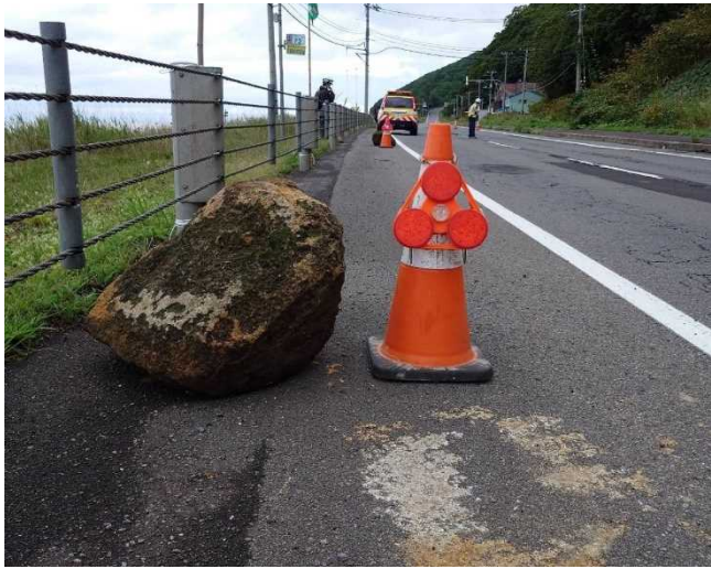
写真①_9 / 19 落石状況 落石径 80cm × 70cm × 60cm程度
