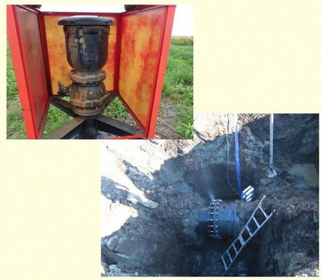
○用水施設の経年的な劣化 (管水路からの漏水・空気弁の劣化)
