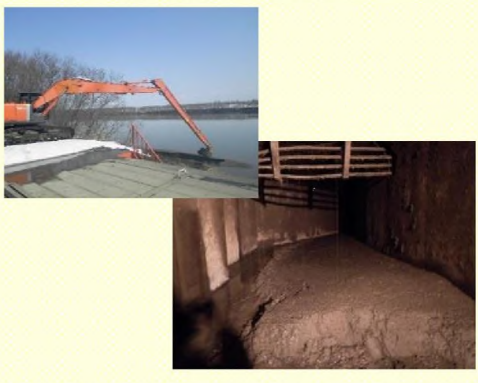
○南美原揚水機の取水阻害 (導水路の堆砂)
