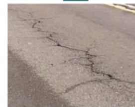
●舗装のひび割れの様子。
