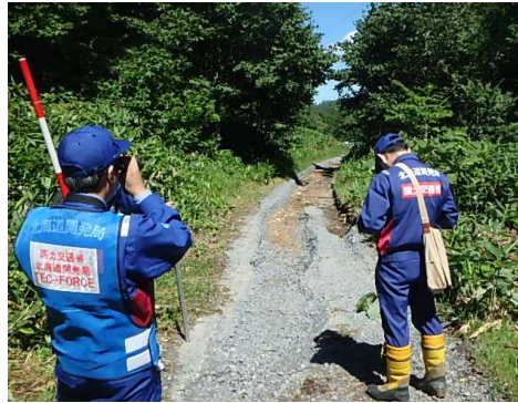
被災道路の現地調査
