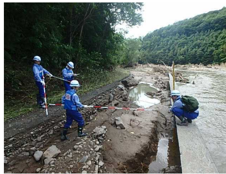
被災道路の現地調査
