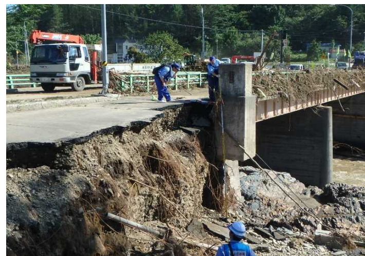
被災橋梁の現地調査(落合地区)
