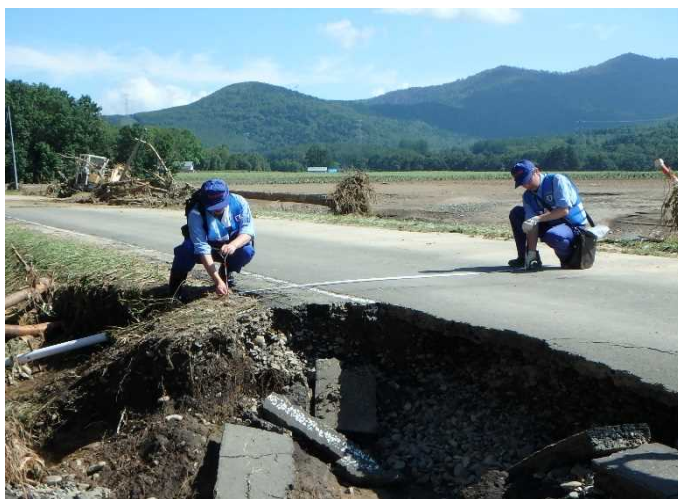
被災道路の現地調査(幾寅地区)
