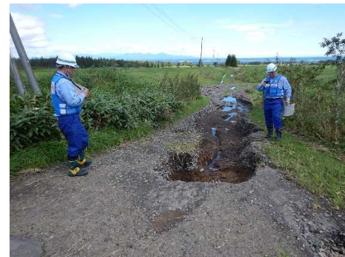
9月7日 町道の被災状況調査
