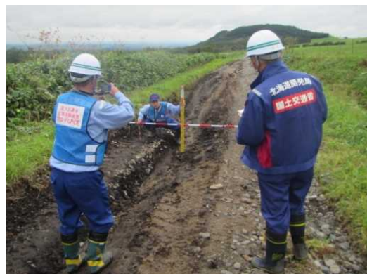
9月8日 町道の被災状況調査
