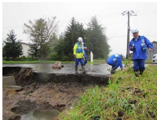
9月9日 町道の被災状況調査
