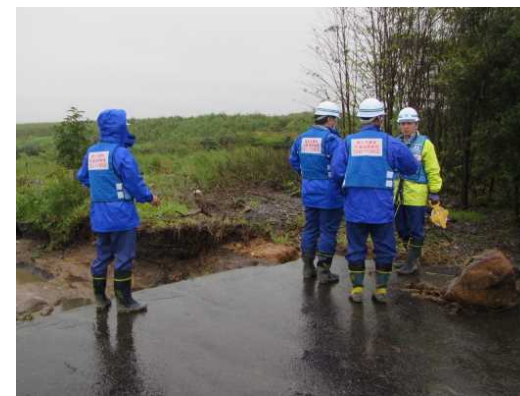
9月9日 町道の被災状況調査
