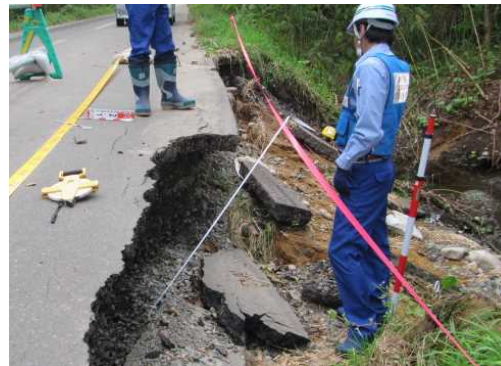
9月12日 町道の被災状況調査 (第2陣)
