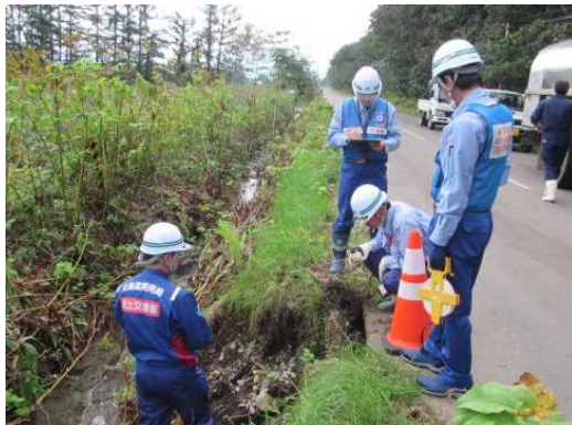
9月12日 町道の被災状況調査 (第2陣)
