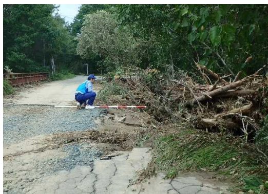
9月3日 現場被災箇所調査
