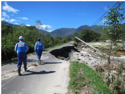
9月11日 町道の被災状況調査
