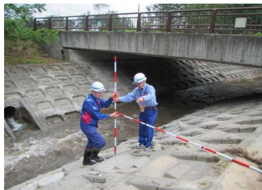
9月13日 町道の被災状況調査
