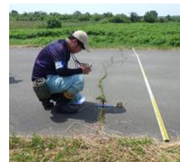
堤防天端横断亀裂(堤防点検)
