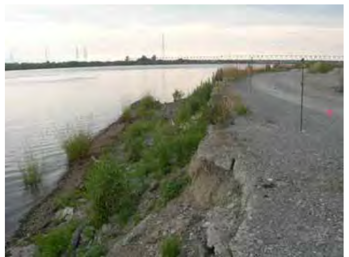
当別川合流点の河岸の状況 ・河岸が崩落し、河畔林も見られない
