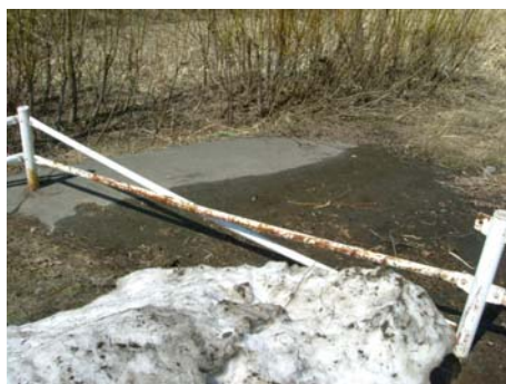
写真 損傷箇所 KP13.7
