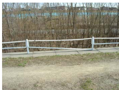
写真 損傷箇所 KP20.0
