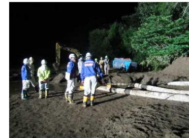
排水ポンプパッケージ(深川市納内)
