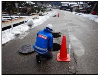
【被災施設の調査】
