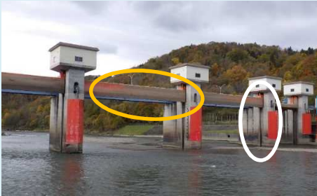
塗装が劣化した 頭首工ゲート
