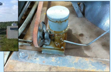
江別太排水機場老朽化状況 (ポンプ設備からの油漏れ)
