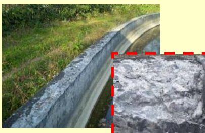
用水路（側壁）のひび割れ
