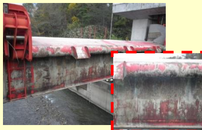
頭首工(ゲート扉体)の劣化
