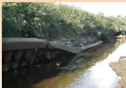
お茶の水排水路 護岸の倒壊
