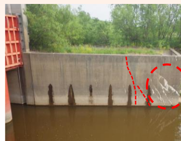
お茶の水排水機場 排水樋門の劣化 (ひび割れ)
