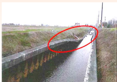
お茶の水第11支線 排水路 護岸の倒壊
