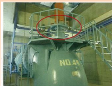
お茶の水排水機場 ポンプ設備の劣化 (漏水)
