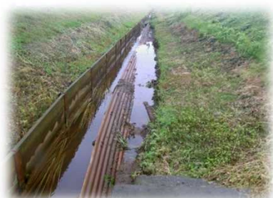
排水路の劣化
