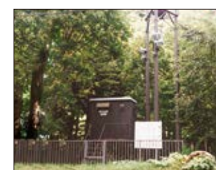
放流警報施設
